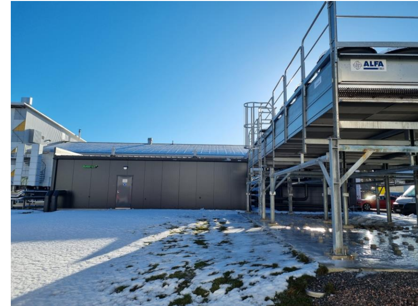
Esimerkikkokuva Calefan AmbiHeat lämpöpumppujärjestelmästä. Kuvassa näkyy pieni tekninen rakennus lämpöpumppuille sekä ulkona olevat ilmalämpökeräimet. Granlund Oy.
