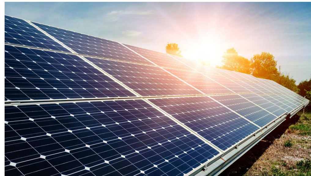
Kuva maahan asennetusta aurinkopaneelirivistä. Granlund Oy.
